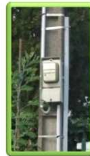
Compteur extérieur apparent
