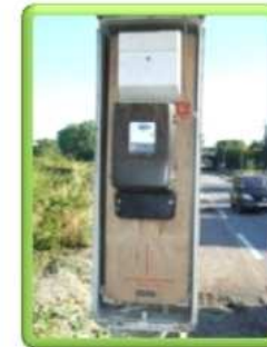
Coffret sur poteau, ouvert
