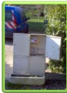
Coffret porte ouverte
