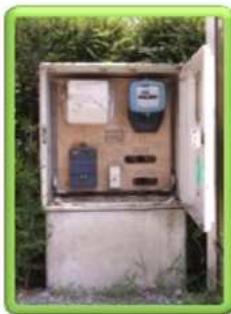
Coffret porte ouverte
