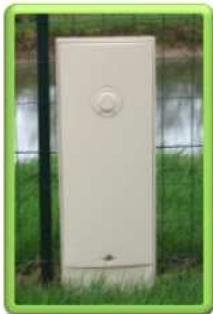
Coffret avec serrure rectangulaire, accès réservé à ERDF
