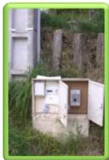
Compteur et disjoncteur dans coffret extérieur (dos à dos)
